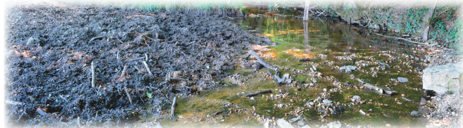
Berges du ruisseau de la Haie Vauthier endommagées par le piétinement du bétail.
