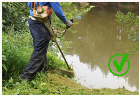
Favorisez le débroussaillage sélectif par une méthode mécanique légère qui ne fragilise pas la berge.
