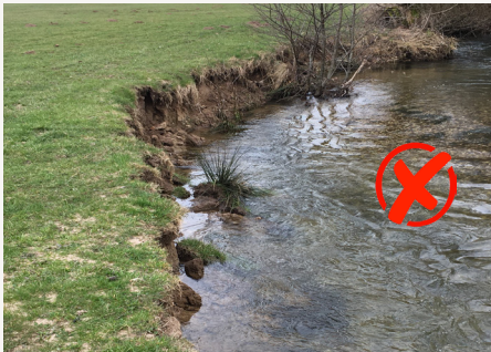
La berge s'affaiblit et s'érode en l'absence d'une ripisylve arborescente.
