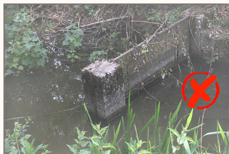
Grille sanitaire inopérante, autorisant le passage des espèces en élevage dans le milieu naturel, et inversement.
