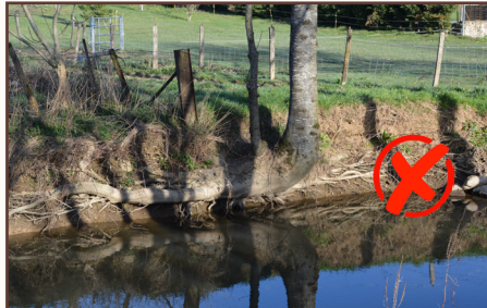
L'incision du lit provoquée par le curage amplifie l'érosion des berges, malgré la végétation en place.
